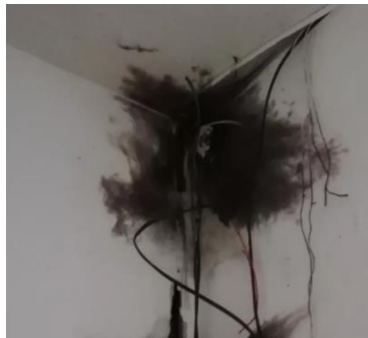
вырванные из стен электрические провода
